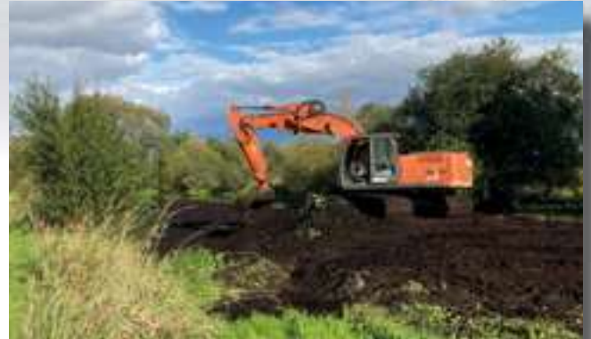
29 septembre 2018 - Restauration progressive du marais par l'élimination de la tourbe minéralisée d'un très ancien bourrelet de curage des canaux.
